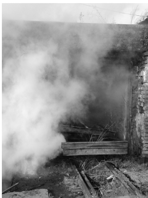
Slika 2. Zidana parionica, loše održavana sa velikim energetske gubicima
