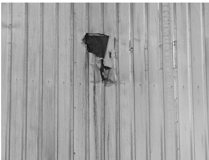
Slika 17. Oštećenje vrata parionice uslijed nepažljive manipulacije viličarom – gubitak toplinske energije Figure 17 Steam chamber damaged door caused by careless forklift truck manipulation – heat energy loss
