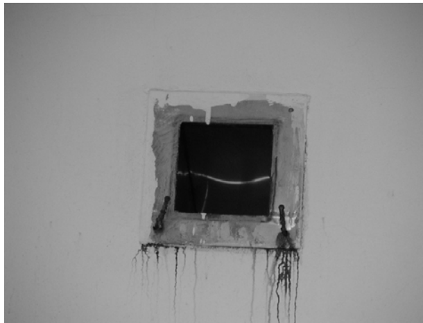
Slika 6. Otvor za ispuštanje viška pare iz parionice neadekvatno postavljen na visini 3 m Figure 6 The vent for removal of steam overflow built on height of 3 m
