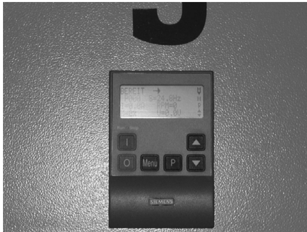
Slika 18. Ekran frekventnog pretvarača u elektroormaru sušionice – značajne uštede električne energije Figure 18 frequency converter display mounted at electrical installation housing – significant savings of electrical energy
