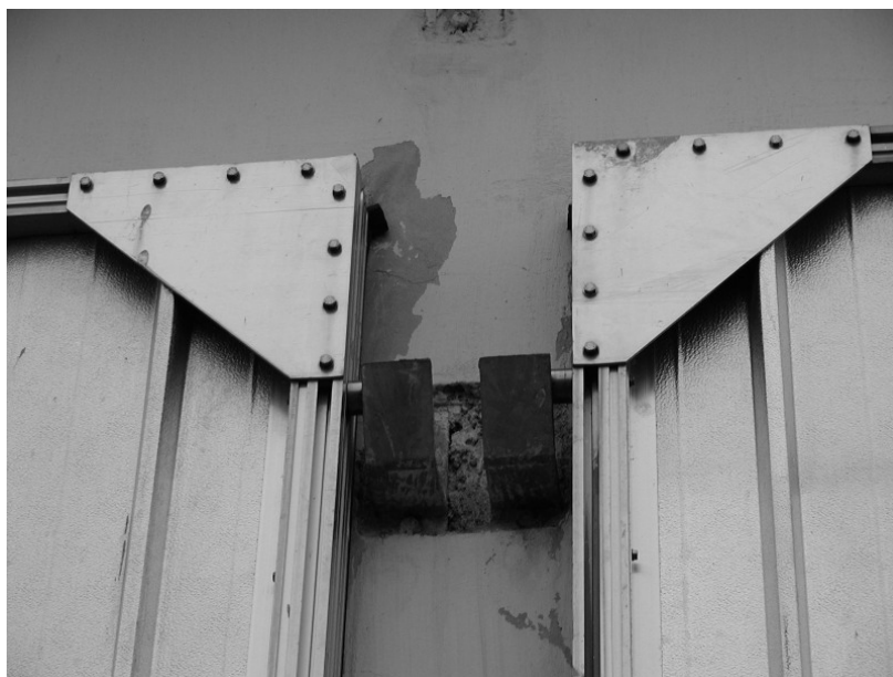
Slika 15. Utjecaj topline na premaz zida sušionice kod lošeg brtvljenja
