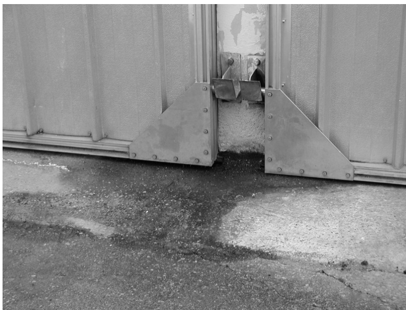
Slika 14. Loše nalijeganje brtvi na okvir vrata sušionice – miješanje vanjskog i unutarnjeg zraka, kondenzacija vlage iz zraka)
