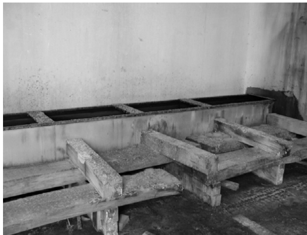
Slika 7. Loše konstrukcijsko rješenje proizvodnje pare kod indirektnog parenja Figure 7 Inadequate construction solution for steam production in indirect steaming process
