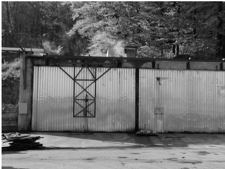
Slika 16. Parionica – kombinacija željeza i nehrđajućeg čelika – kondenzacija vodene pare zbog lošeg brtvljenja vrata i propadanja okvira i konstrukcije vrata zbog agresivne kisele sredine
